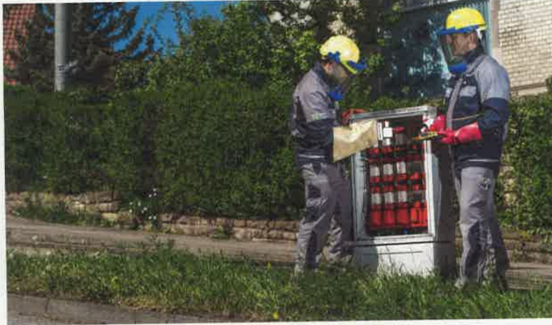
Anfang 2020 hat die Stuttgart Netze gemeinsam mit den Partnern Smight und Omega-Lambda-Tec ein Projekt gestartet, mit dem der Netzbetreiber mehr über die Gründe für Stromausfälle herausfinden und sein Netz besser überwachen will. Nun liegen erste konkrete Ergebnisse aus dem zweiten Projektteil mit dem Fokus auf das Thema Künstliche Intelligenz (KI) vor. Dabei zeigt sich, dass durch gezieltes Training eines Algorithmus erstmals defekte Kabel gezielt detektiert werden konnten. Bild: Stuttgart Netze GmbH
