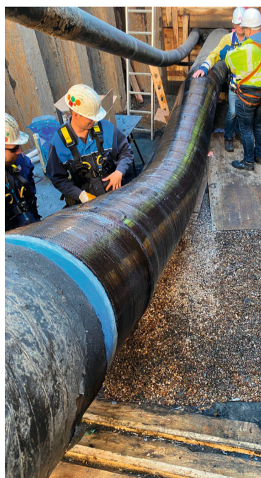
Blick auf die vollständig reparierte Strecke. Im Test erreichte die Härte des zur Sanierung genutzten Atlas-Systems Shore D 90 und lag damit über den geforderten Shore D 80.
