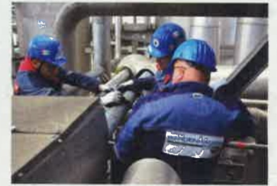
Insgesamt benötigten drei Techniker für die Installation des Eintauchschiebers samt Anfräsen und Verschließen der Kühlwasserleitung nur anderthalb Stunden.
