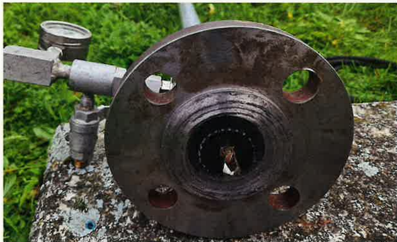
Einsatzbereite Hot-Tapping-Maschine mit Pilotbohrer und Lochsäge.
