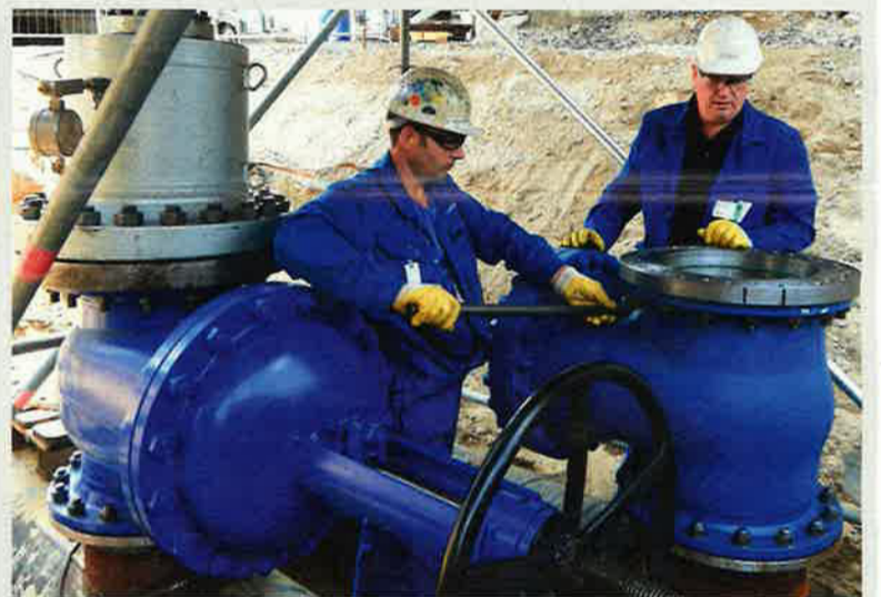
Die 150 Mitarbeiter der Bardenhagen-Gruppe unterstützen Firmen der chemischen, petrochemischen und anderer Prozessindustrien deutschlandweit mit spezialisierten Instandhaltungs- und Reparaturservices vor Ort beim Kunden. Zu den Dienstleistungen gehören Armaturenreparatur, Leckabdichtung im laufenden Betrieb, mobile mechanische Bearbeitung und andere Spezialservices. Bild: Bardenhagen
